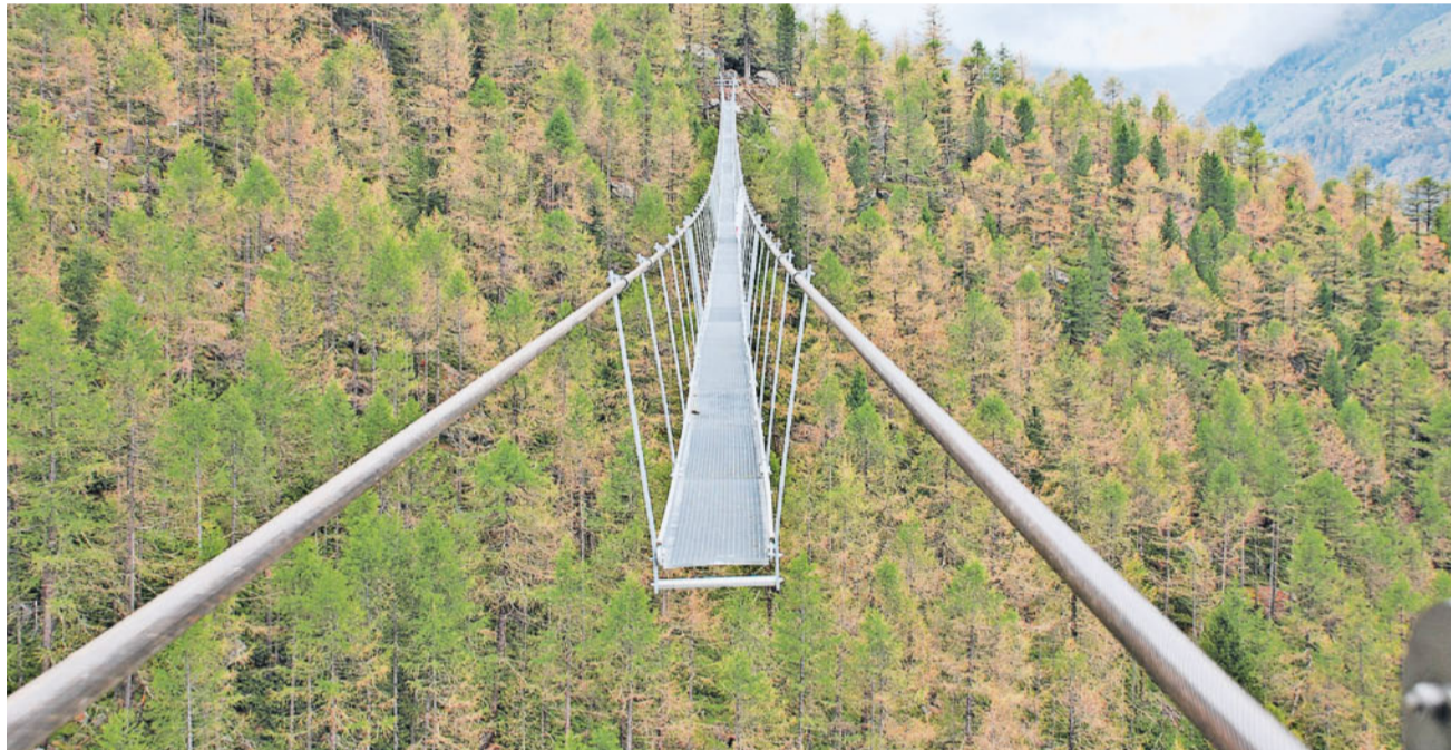
Stück um Stück. Noch endet die neue «Europabrücke» im Niemandsland. Doch sie wächst jeden Tag. FOTO WB
